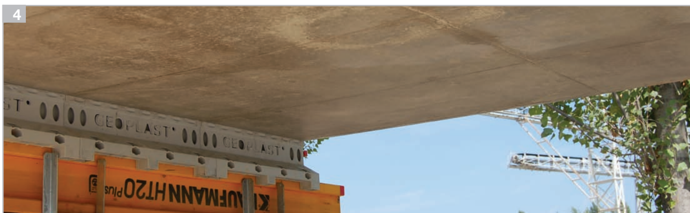
4 Efekt końcowy po ściągnięciu się betonu
